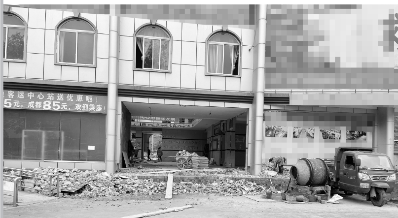
正在装修改造的马边彝族自治县客运中心站交邮合作场地
