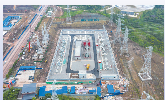
乐山红云220千伏输变电工程投入运营
