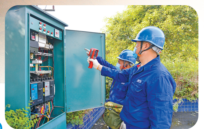
检测供电设备,保障疫情防控供电安全可靠。 国网乐山供电公司 供图
