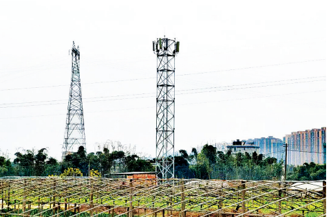
市中区牟子镇菜利村新建成的4G信号基站 市中区融媒体中心 供图
