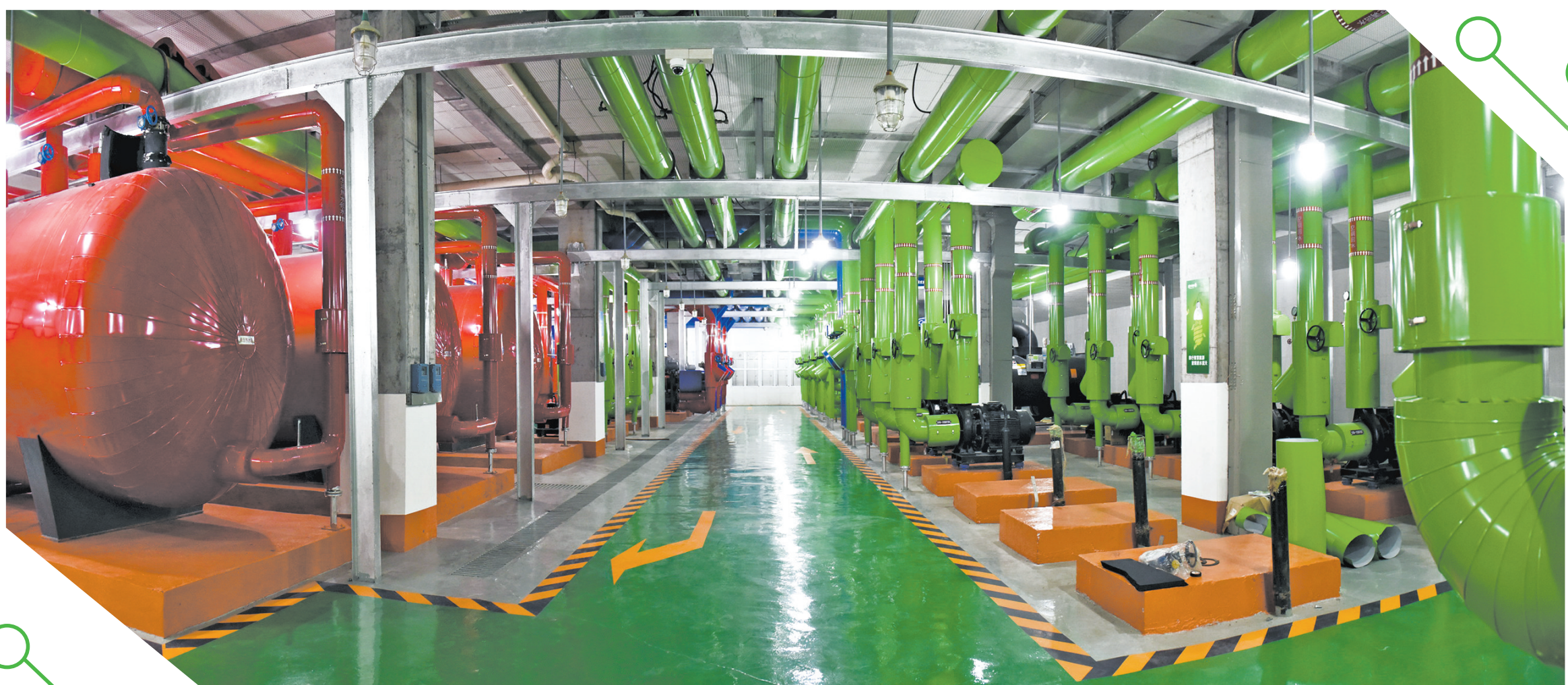
乐山职业技术学院智慧能源中心(校园整体使用了水源式热泵技术,利用青衣江资源,夏天制冷、冬天供暖)
