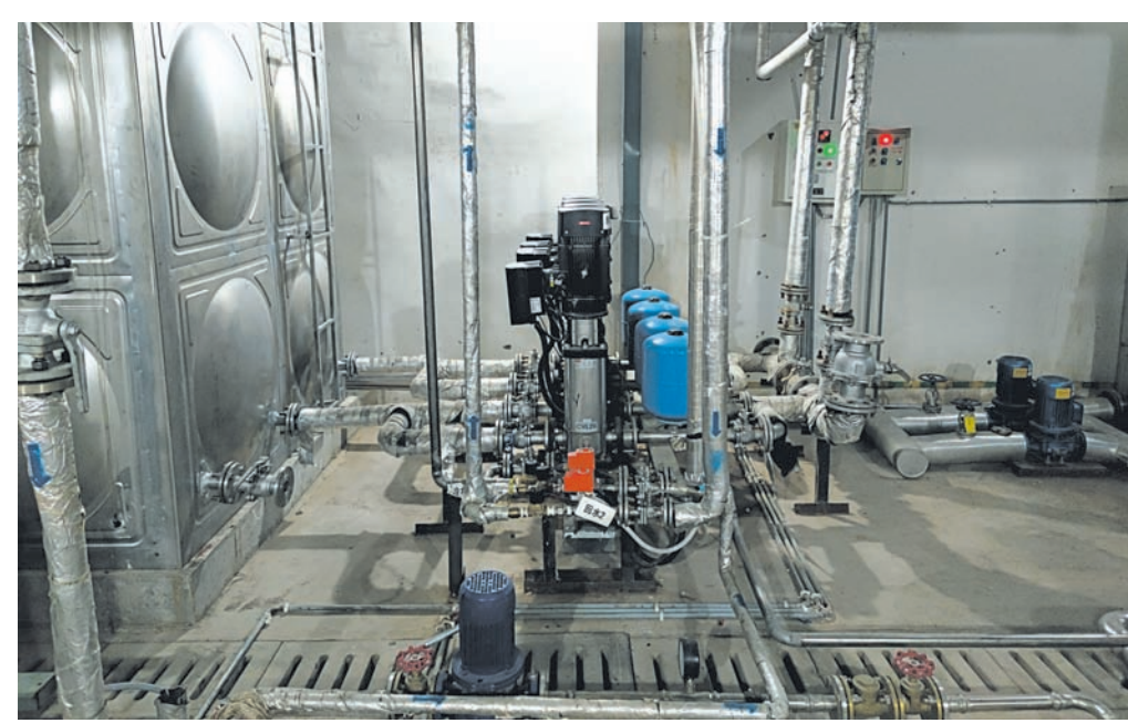
市妇幼保健院雨水收集绿化喷灌系统(节能环保,无淤泥杂质留存)
