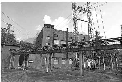
四川第一个220千伏变电站666变电站
