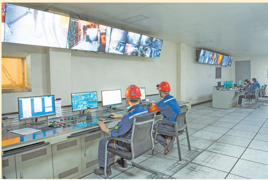
德胜钒钛炼钢控制室
