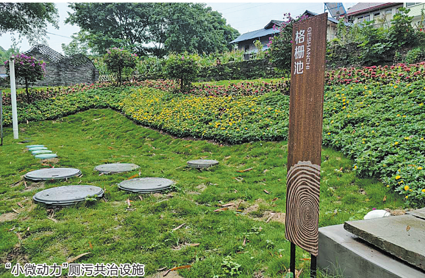
“小微动力”厕污共治设施
