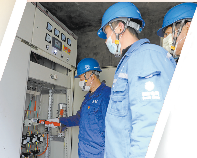
为五通桥区金山镇民安村村提灌站检查配电设施
