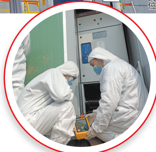
工作人员检查新希望集团大型养猪场10千伏电缆及配变,助推企业复工复产。
