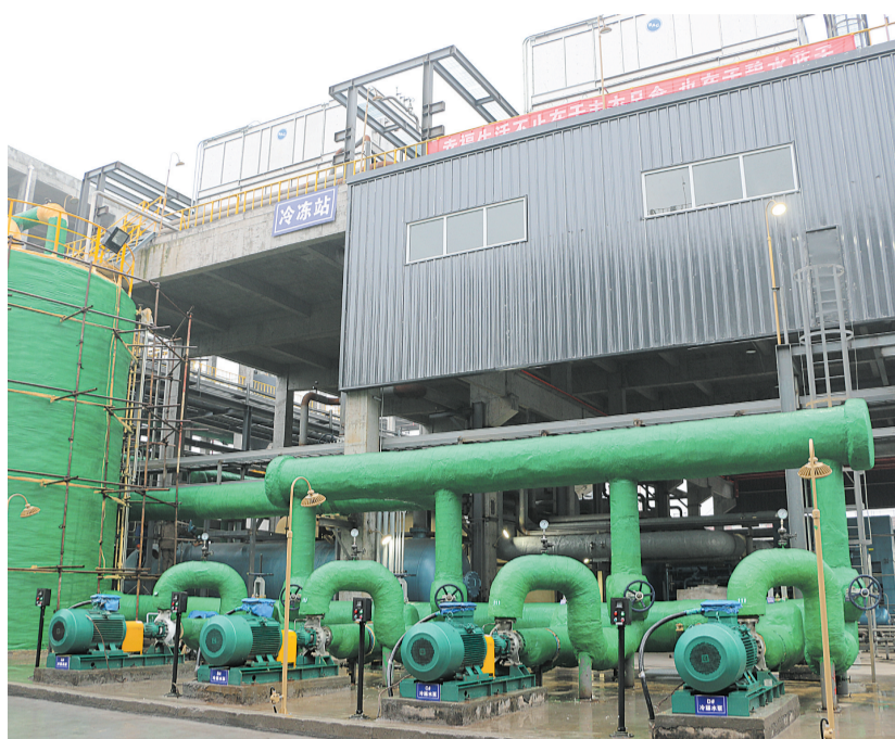
和邦集团厂区内“环保资源循环回收利用”项目的冷冻站
