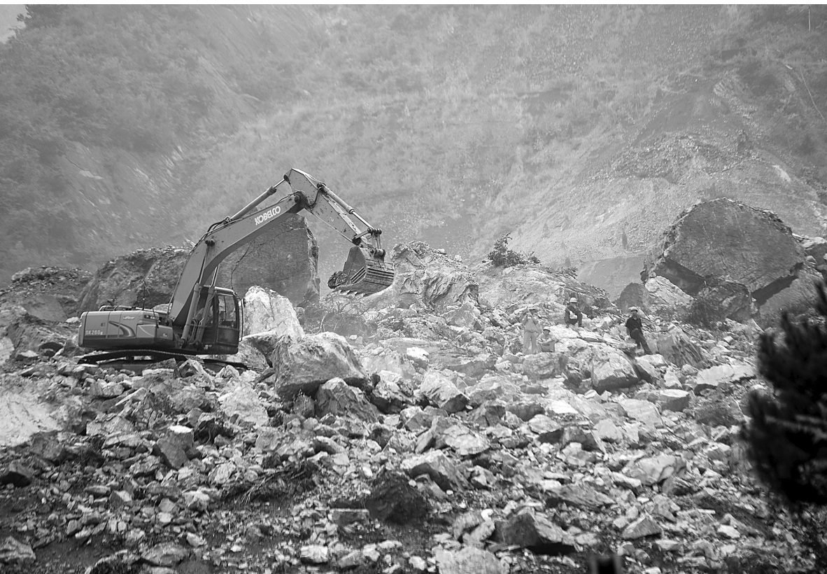
8月12日，抢险人员在山体滑坡事故现场清理土石方。
